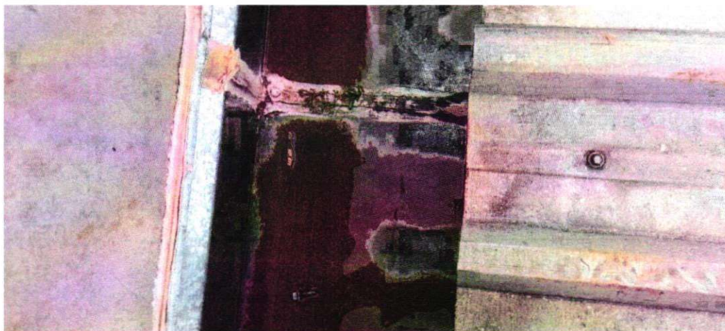
Foto 8 Análise da emenda feita nas calhas
